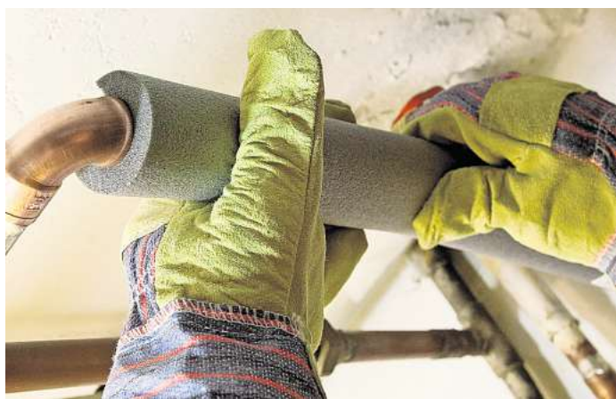
DAMIT DIE WÄRME NICHT SCHON IM KELLER VERPUFFT: Ungedämmte Heizungsrohre zu isolieren, kann viel Energie und damit auch jede Menge Geld sparen. Foto: Kai Remmers/dpa/dpa-mag
