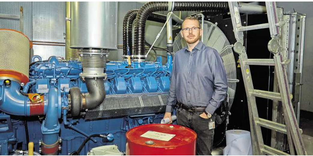
Fritz Seltmann ist stellvertretender technischer Leiter am Klinikum Altenburg. Um auf einen Stromausfall vorbereitet zu sein, hat das Krankenhaus einen neuen Notstromaggregat. Foto: Andy Drabek
