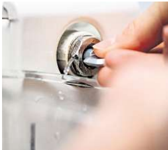
Das Heizungsventil sollte so lange offenbleiben, bis der Heizkörper nicht mehr gluckert. Foto: Andrea Warnecke/dpa
