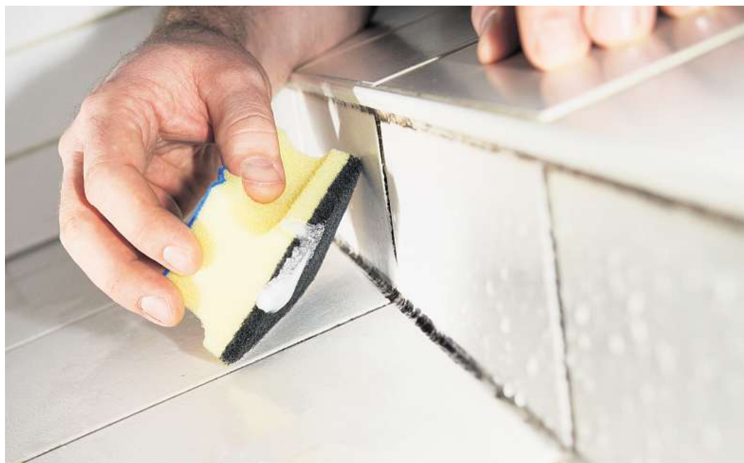
SCHWARZE FLECKEN AUF DEN FUGEN? Oft lassen sie sich mit speziellen Reinigern entfernen. Sitzt der Schimmel zu tief, sollte man die Fugen besser erneuern. Foto: Franziska Gabbert/dpa
