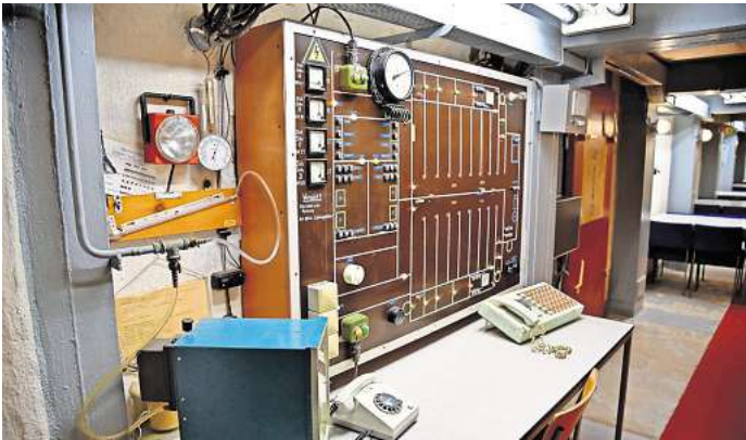
So sieht die Schaltzentrale im Stasi-Bunker in Machern aus. Foto: Frank Schmidt
