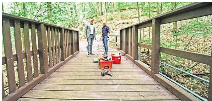
Die neue Brücke in der Kühlen Schlucht am Ortsausgang von Döbeln besteht jetzt aus einem witterungsbeständigen Recycling-Kunststoff. Foto: Sven Bartsch
