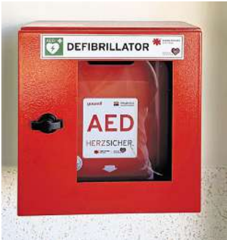
Der neue Defibrillator der Artur-Becker-Oberschule hängt gut sichtbar im ersten Obergeschoss.
