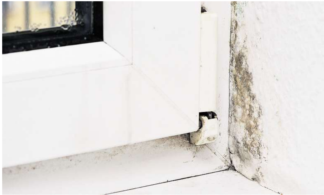
MIT 70-PROZENTIGEM ETHYLALKOHOL soll sich kleinflächiger Schimmelpilz in der Wohnung beseitigen lassen.
