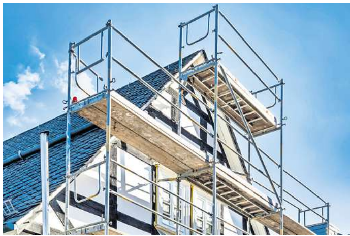
Richtig geplant, lohnt sich eine energetische Modernisierung des Eigenheims auch bei ungünstigen Rahmenbedingungen. Foto: djd/Bauherren-Schutzbund/Getty Images/Fotomax
